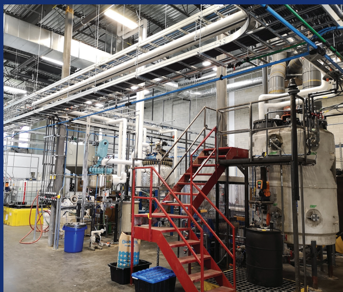
Usine de démonstration à Anjou
